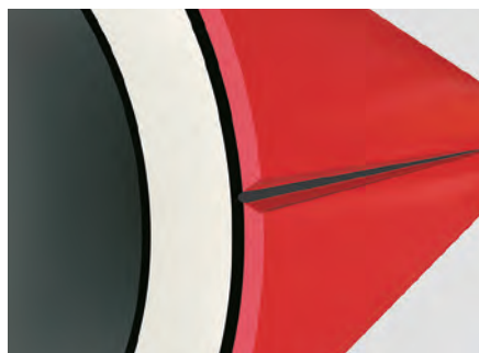
Рис. 8. Труба имеет незначительное повреждение, эксплуатация возможна
